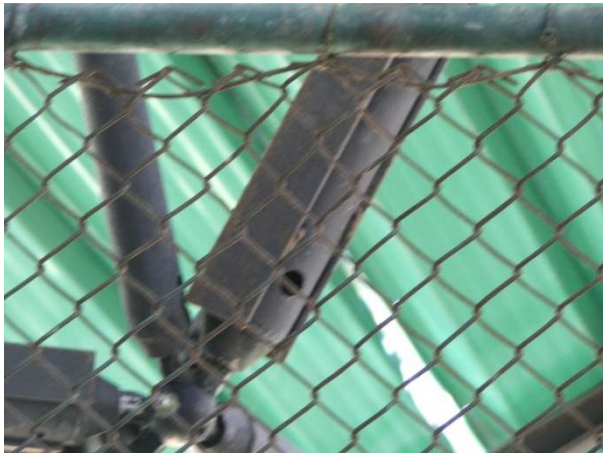
Foto 12 – Detalhe da estrutura com barras de reforços estruturais em forma de perfis do tipo cantoneiras, soldados as barras tubulares.
