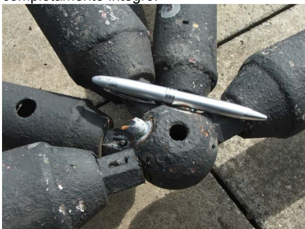
Foto 10 – Detalhe do tipo de conexão (nó) entre as barras da estrutura e rompimento de um dos parafusos.
