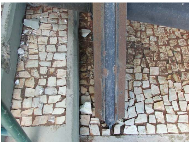
Foto 16 – Detalhe de uma barra que se despreendeu totalmente da estrutura, apresentando reforço estrutural.
