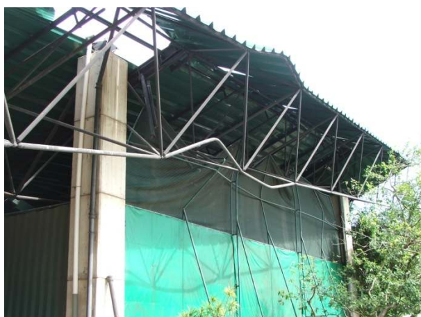
Foto 2 – Deformação de barras do beiral da estrutura, ocorrida após o sinistro, sendo parte da estrutura ainda apoiada em um dos pilares, nota-se ausência de corrosão.
