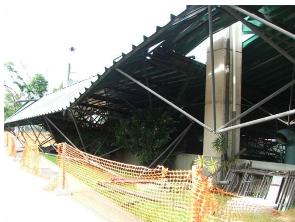
Foto 3 – Parte da estrutura deformada e apoiada sobre o piso.
