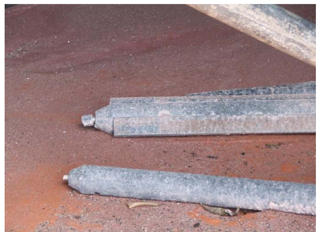
Foto 17 - Detalhe de duas barras que se desprenderam da estrutura, sendo uma delas com reforços.
