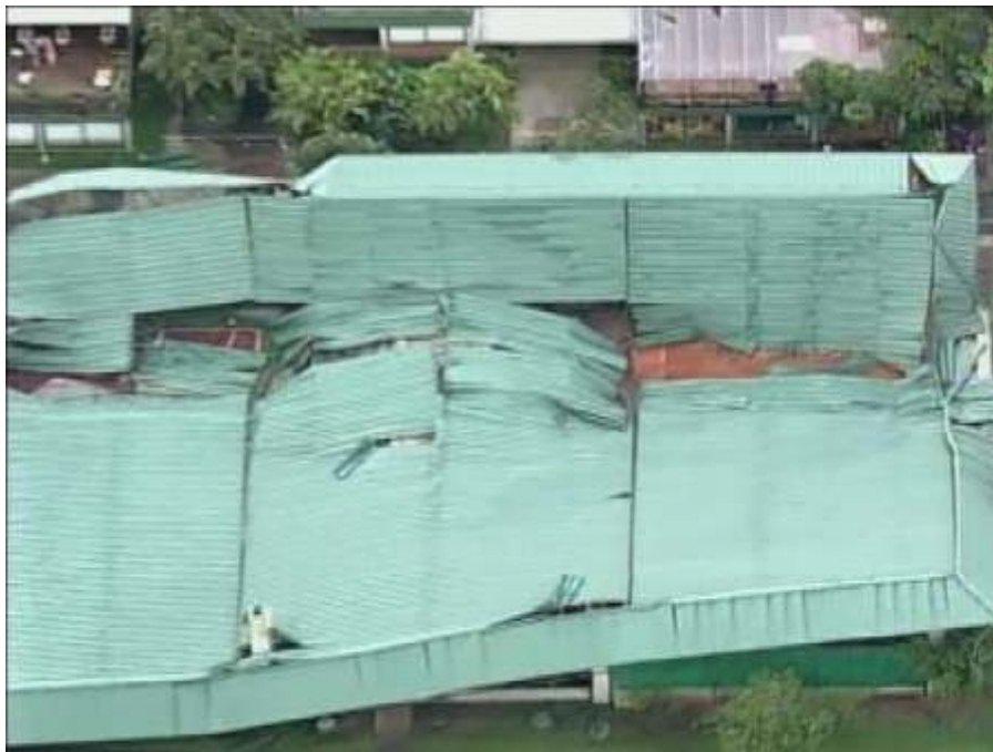
Foto 01 – Visão geral da estrutura após o sinistro
