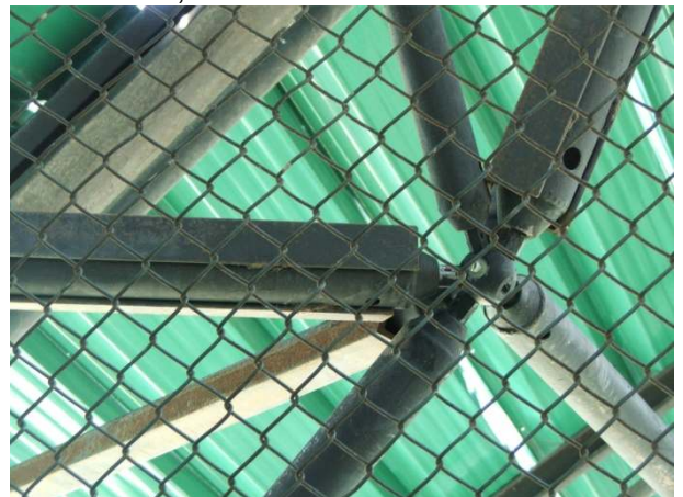
Foto 15 – Detalhe da estrutura com barras de reforços estruturais em forma de perfis do tipo cantoneiras, soldados as barras tubulares.
