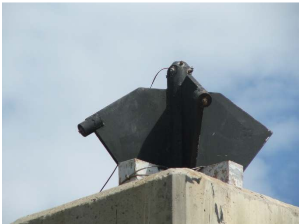
Foto 8 – Detalhe de um dos pontos de fixação, totalmente rompido, na fixação entre o nó e a estrutura, observando o pilar completamente íntegro.
